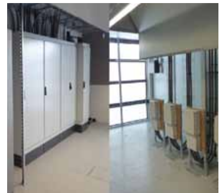
Elektrische installatie UPS (rechts) en verdeelinrichting (links).
