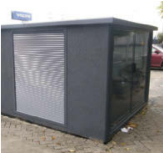
Transformator met omkasting.
