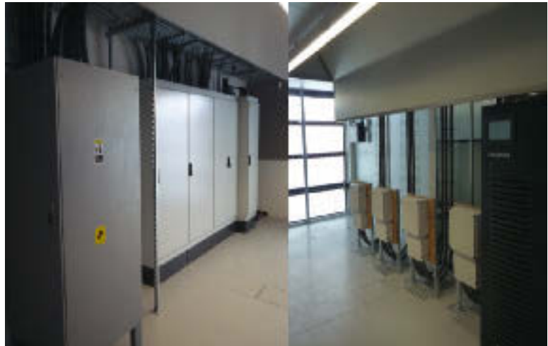
Elektrische installatie UPS (rechts) en verdeelinrichting (links).
