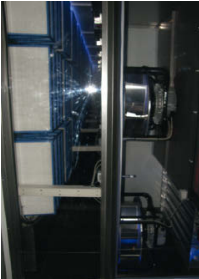
Rechts twee stuks energiezuinige EC-ventilatoren en links de filters.
