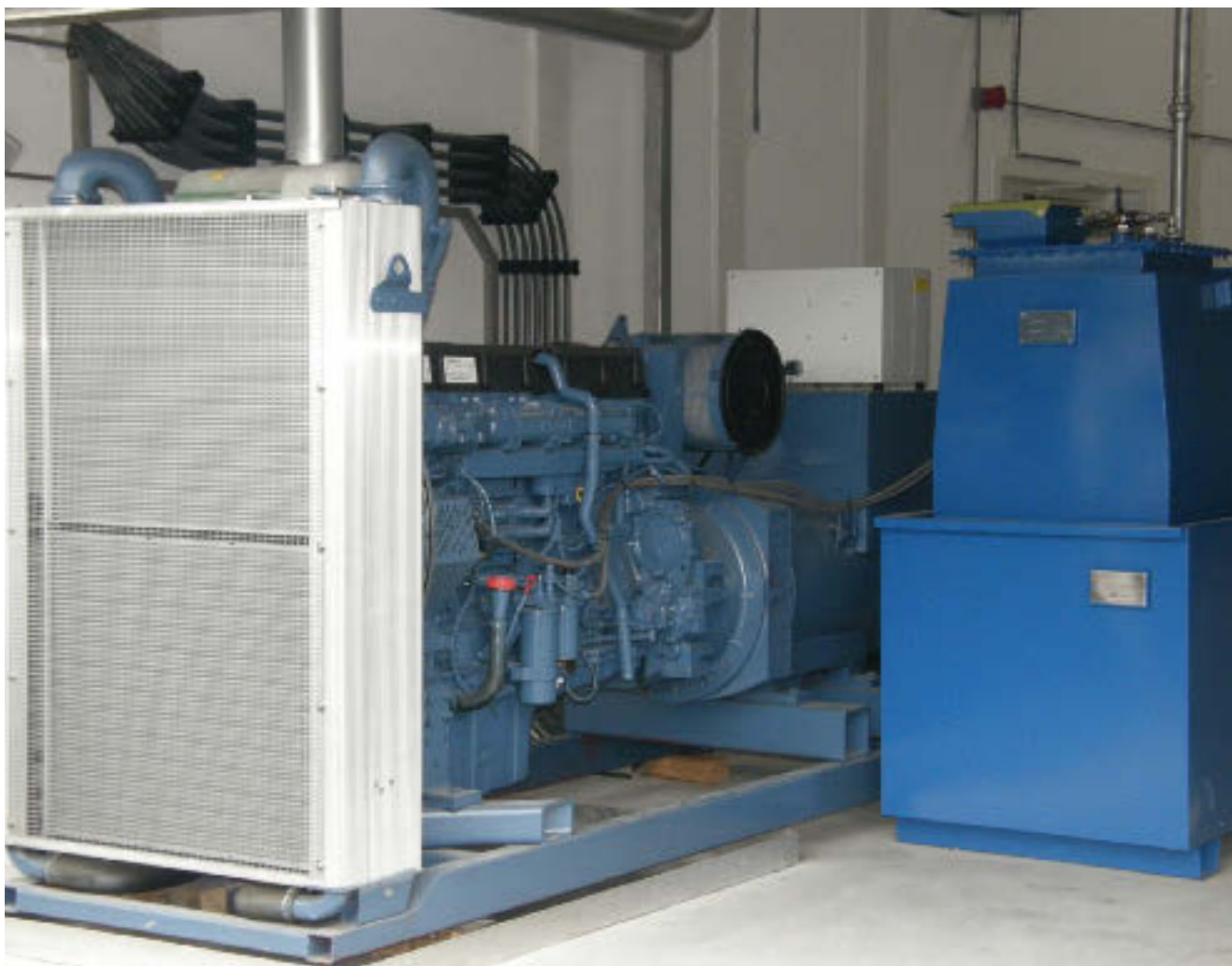
Noodstroomaggregaat is stand by voor uitval van het elektriciteitsnet.
